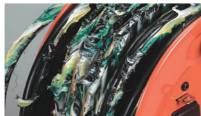
過電流によって溶解した電線(溶解実験写真)
