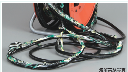
異常加熱により溶けた電線
